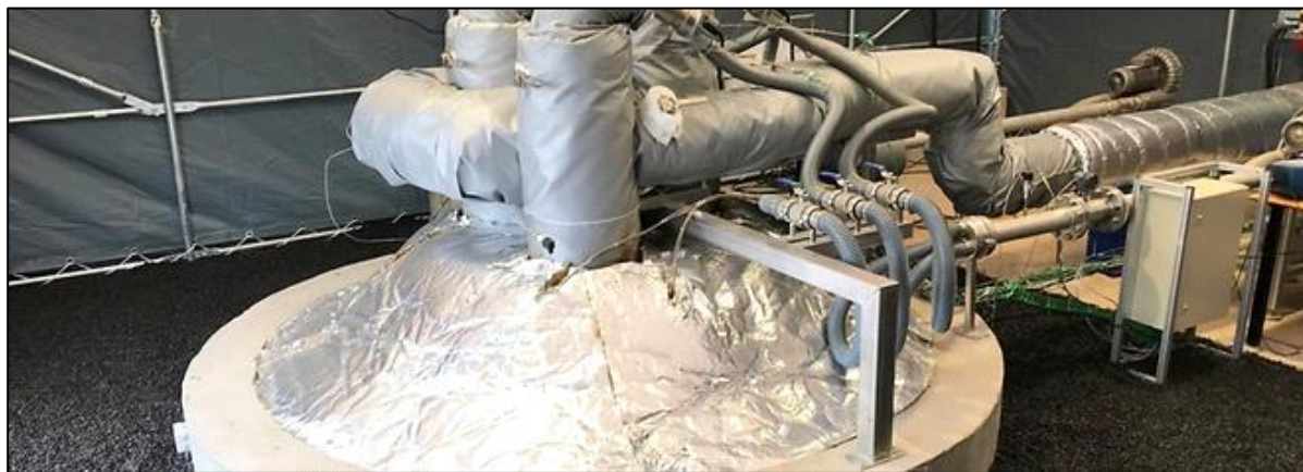
Foto 13. Seas-NVE Ing.dk. Det øverste af energilageret på DTU Risø. Det meste af den kugleformede stålkapsel, som er fyldt med varme sten, er støbt ned i fundamentet.
